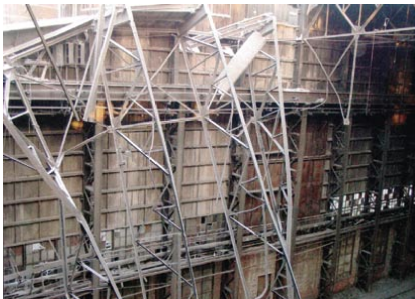
Рис. 1. Стропильные фермы шихтового пролета Г–Д, зависшие на колоннах по ряду Д после обрушения (ОАО «Ижорские заводы»)
