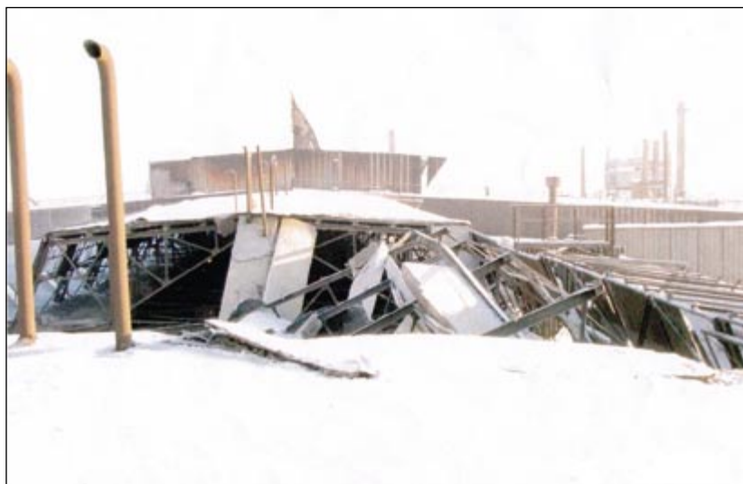
Рис. 2. Конструкции фонаря по ряду В после обрушения (ОАО «Ижорские заводы»)
